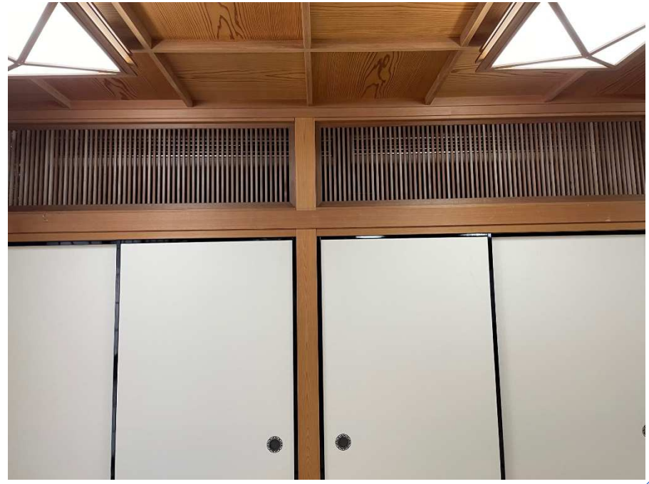
2 F 和室冷暖房設備 (押入れの上部に2機)
