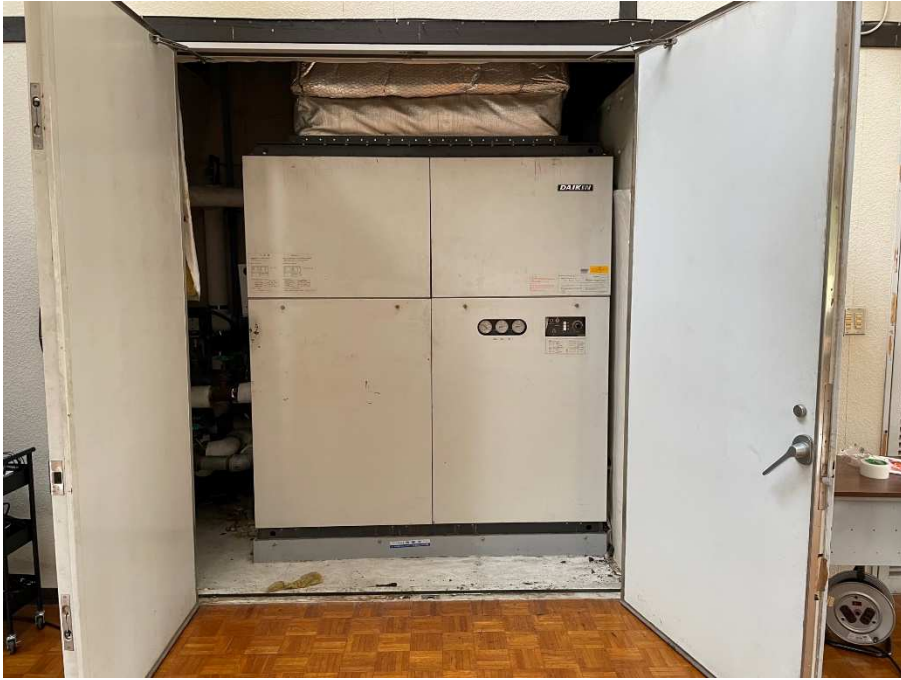
2 F 冷暖房設備 (S 5 6 年より使用)
